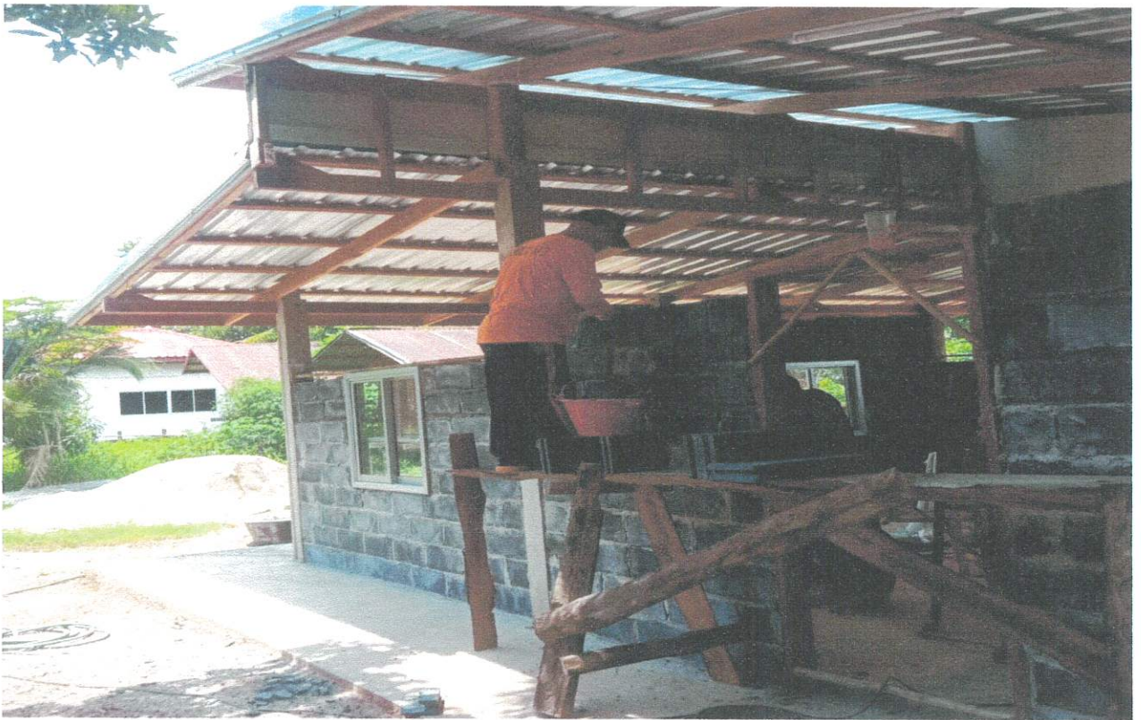
ภาพถ่ายสภาพบ้านของคนพิการ(ก่อนการดำเนินการ)
